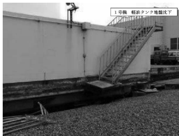
写真-4 1号機経由タンク周辺地盤の沈下 [4]
