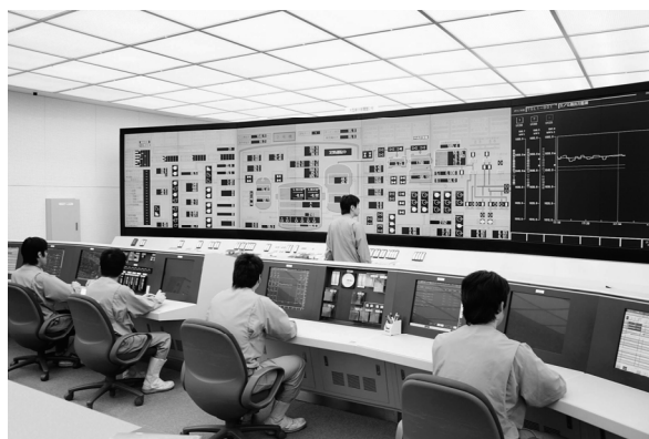
図-1. 新型中央制御盤
