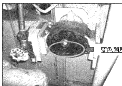
図8 液状化、変色したカム部のグリス
