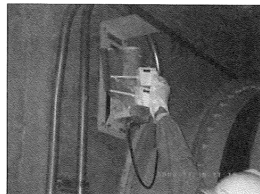
図7 浜岡原子力発電所での確認状況 (主蒸気管モニタに接触させた状態)
