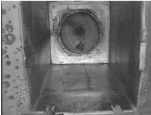
図7 排気用フィルターケーシング内部
