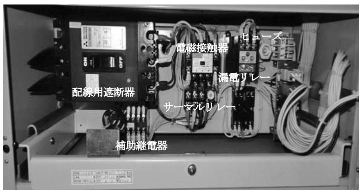
図4. ユニット内部の写真
