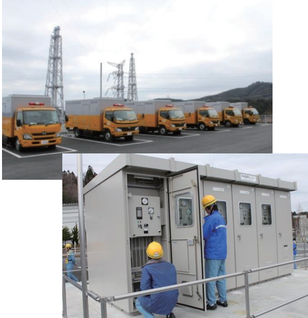
Fig.4 高台電源センター (about 60 m above sea level)
