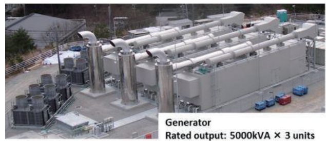
Fig.2 大容量電源装置
