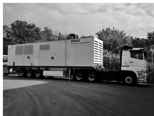
図5 可搬型代替電源車
