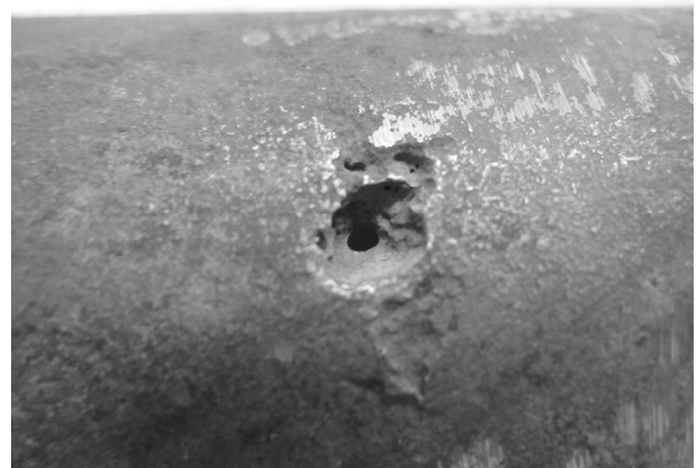
図3 貫通孔が発見された対流蒸発管
