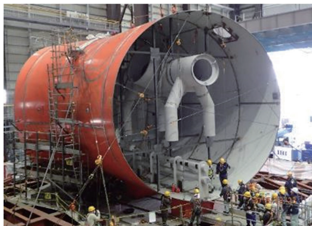
図5 技術研究組合国際廃炉研究開発機構(IRID)の圧力抑制室の止水のためドーナツ状の抑制室を1/8にカットした実寸大モックアップ装置(断面の直径8m)の組み立て。
