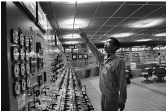
図10 中央制御室対応訓練の状況
