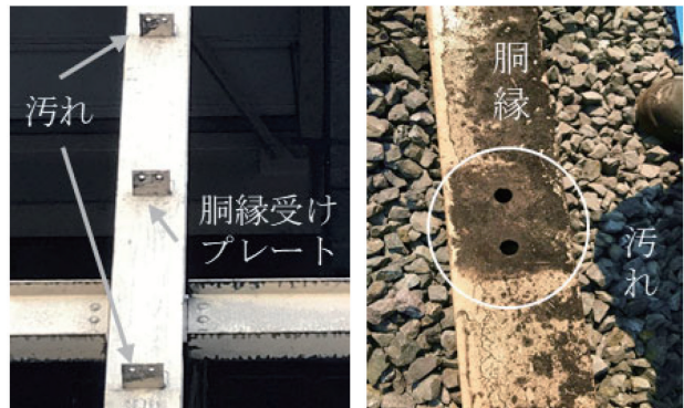
図2 胴縁と胴縁受けプレート間の汚れ
