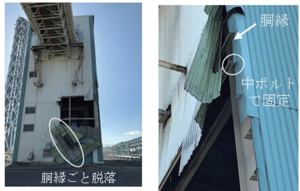
図1 不具合事例(建屋東面外壁の剥がれ)
