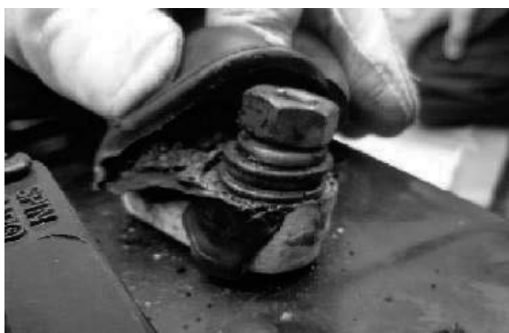
図3 蓄電池電極部カバー内部 (ケーブル端子部)
