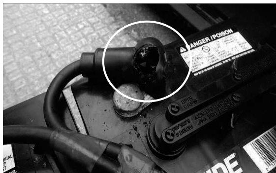
図2 蓄電池電極部カバー焦げ痕
