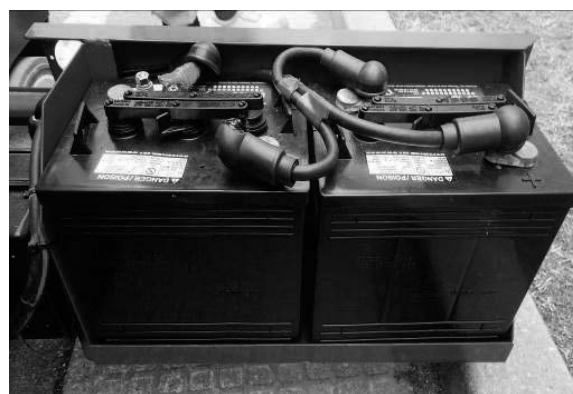
図6 蓄電池収納状態
