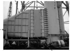
ダクト ヘロース 主排気筒
