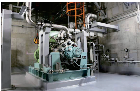
図 14 代替格納容器スプレイポンプ（図 13 の①）
