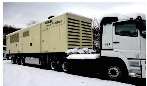
図12 可搬型代替電源車 (図10の②)
