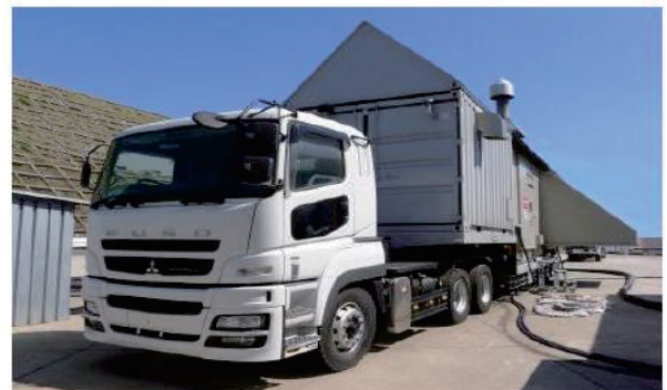
図11 代替非常用発電機 (図10の①)
