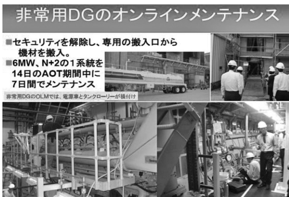
図 8 非常用 DG の OLM 事例
