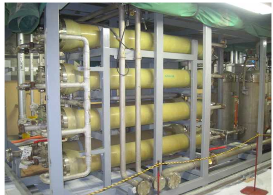
図 6 仮設吸着塔・仮設淡水化装置
