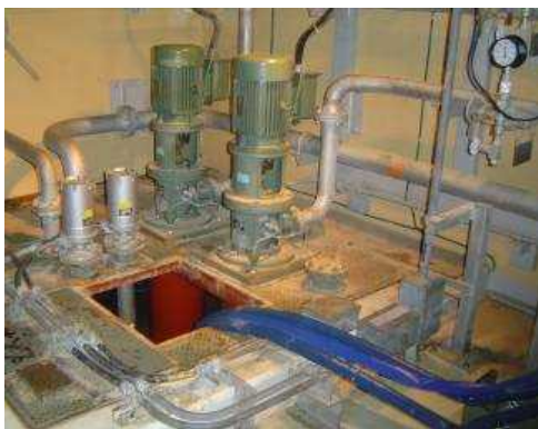
図3 仮設ポンプ・仮設ホース
