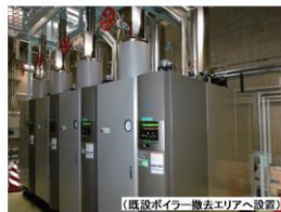
新たに設置した小型ボイラ外観
