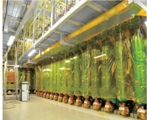
図2 工事エリア内の保管状況 (制御棒駆動水圧制御ユニット)
