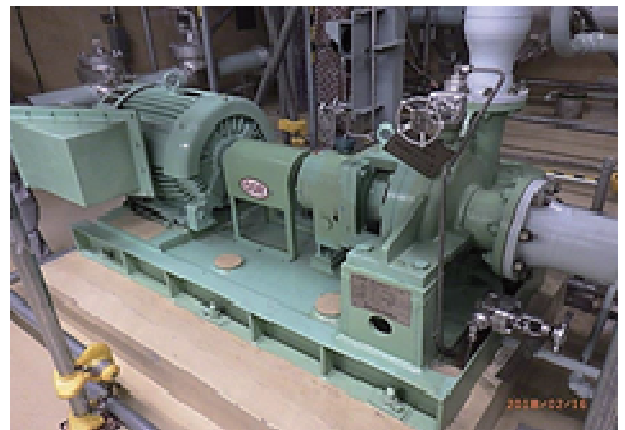
写真1 復水移送ポンプ
