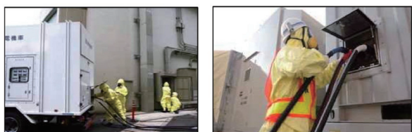
◇高圧発電機車の電源ケーブル接続 (汚染防護具着用) ◇中容量発電機車の電源ケーブル接続 (汚染防護具着用)
