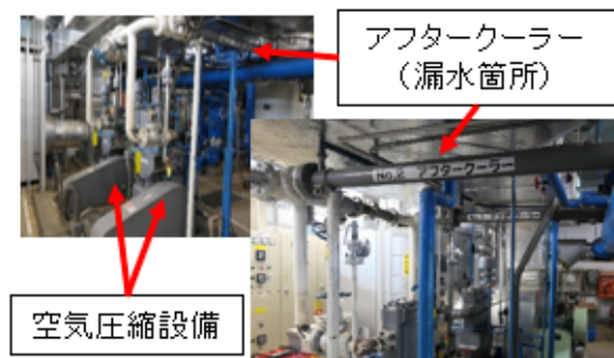
図2 空気圧縮設備 (アフタークーラー)
