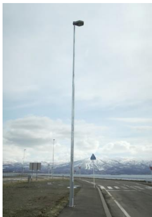
図1 既設道路照明
