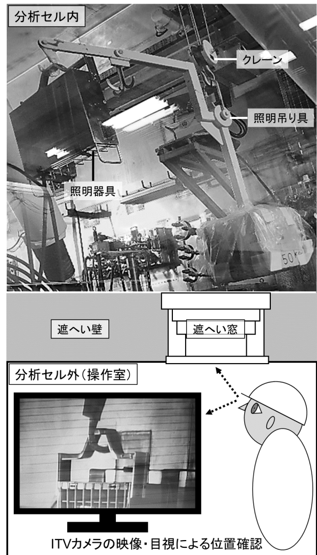
図8 照明吊り具を用いたセル内照明器具のランプ交換
