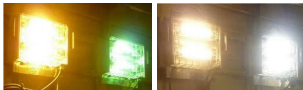
既設照明点灯状況 ナトリウム(左)、水銀(右) LED 照明点灯状況 3000K(左)、5000K(右)
